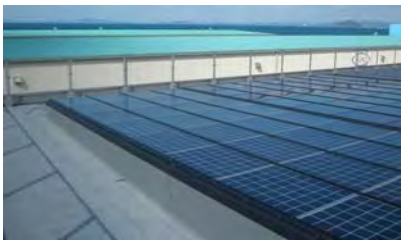
松山第三工場事務棟屋上の太陽電池
